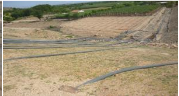
Hình 2-3: Đường ống người dân tự đặt để bơm dẫn nước từ lòng hồ về khu tưới
